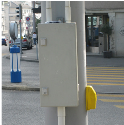
Schaltkasten Fahrleitung VBZ
