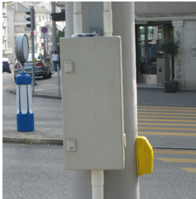
Schaltkasten Fahrleitung VBZ
